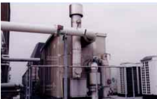
ガス吸収式冷温水機
