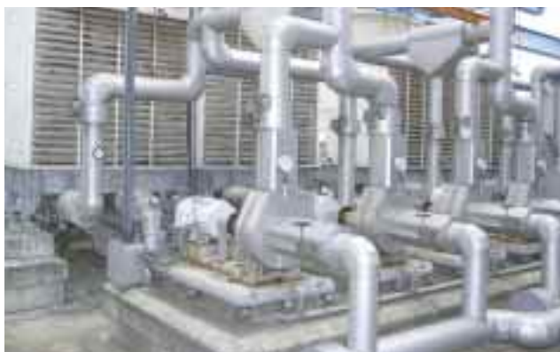
生産設備の冷却水ポンプのインバーター化
