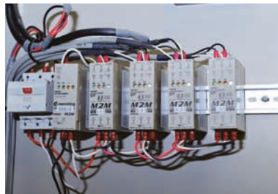
配電盤とガスメーターにつけた「見える化」のシステムのセンサー
