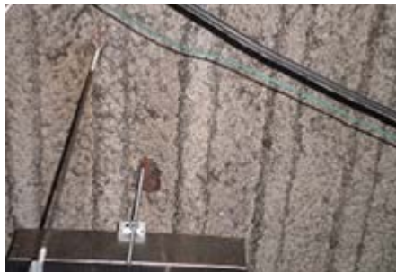
天井開口部から見たアスベスト
